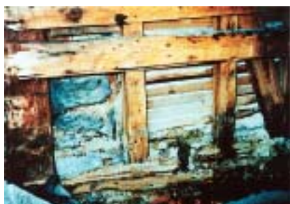
腐朽被害状況
