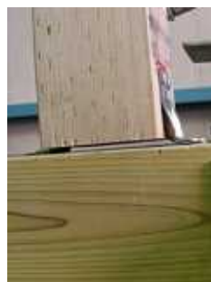
後施工柱の浮き上がり
