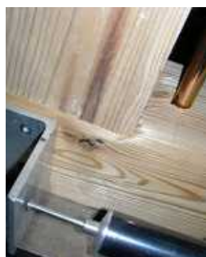
柱のめり込み
